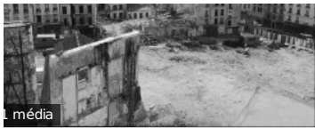
Rue des Gardes - Destruction des immeubles
